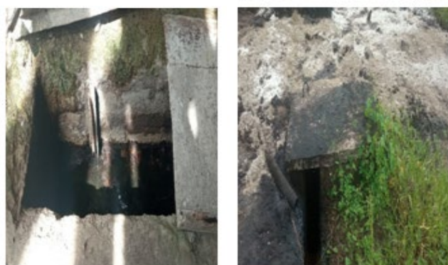
Figura 12. Estado actual del sistema de alcantarillado de la EEA
