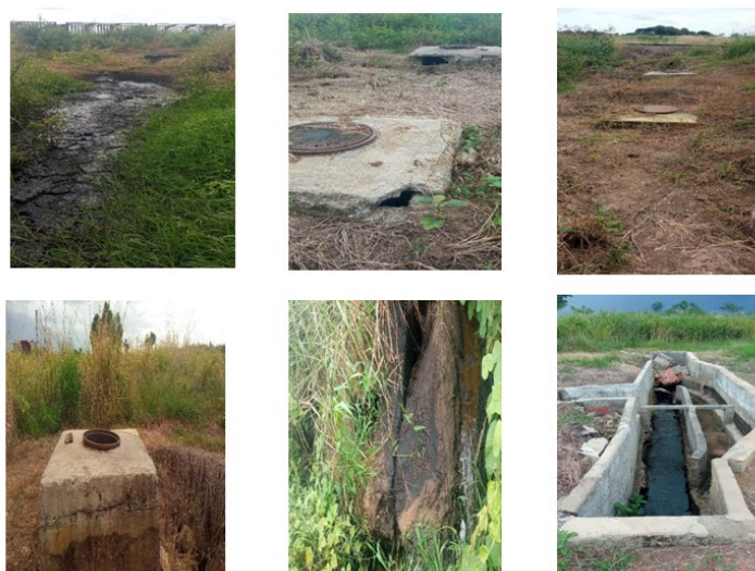
Figura 13. Estado actual del sistema de pre tratamiento de la EEA
