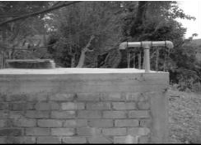
Figura 7. Detalles de la ventilación de las cisternas.
