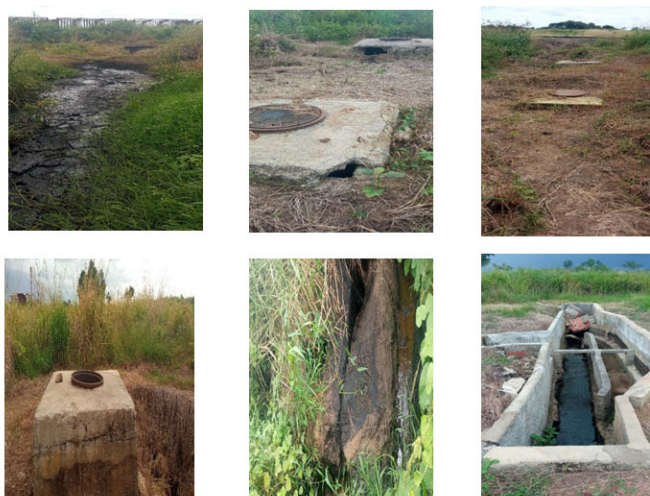
Figura 13. Estado actual del sistema de pre tratamiento de la EEA
