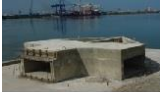
Figura 1. Obra de protección del dren pluvial calle Belascoaín, denominada punto de lanza CIH. Tomada de Córdova et al. (2016)
