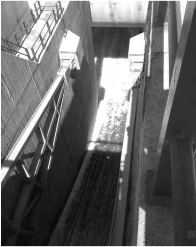
Figura 24. Vista de una de las compuertas de la presa Francisco Zarco. Se aprecia el inicio del túnel
