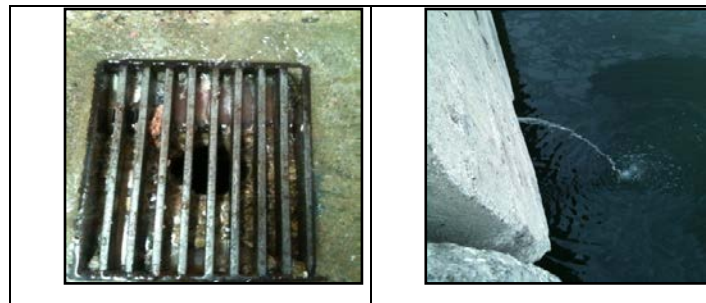
Figura 5. Tuberías de conducción de agua residual con registro de la planta de embutidos y vertimiento directo a la bahía
