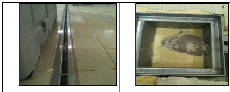
Figura 4. Canal de vertimiento de aguas residuales y trampa de sólidos de la planta de conformados
