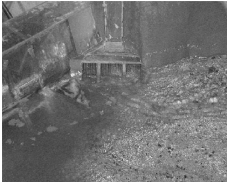
Figura 7. (fotografía 5). La bocatoma operando en la nueva ubicación sigue teniendo graves problemas (con el muro divisorio)
