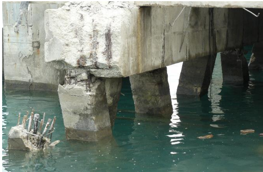
Figura 3. Pilotes cizallados por licuefacción en Manta, Ecuador, como consecuencia del sismo de Abril 16, 2016 (foto del autor).
