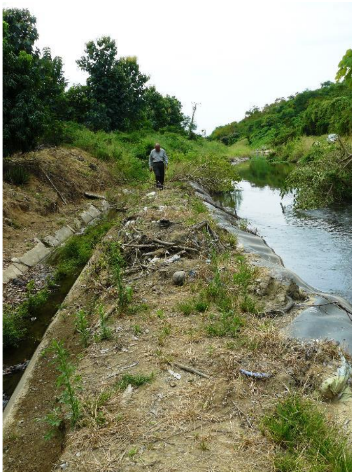
Figura 1. Desmantelamiento parcial de un tramo del Canal Crucita por soliflucción. Este proceso comprimió las paredes revestidas con hormigón del canal, causando fracturamiento y un estrechamiento de casi dos metros (foto del autor)
